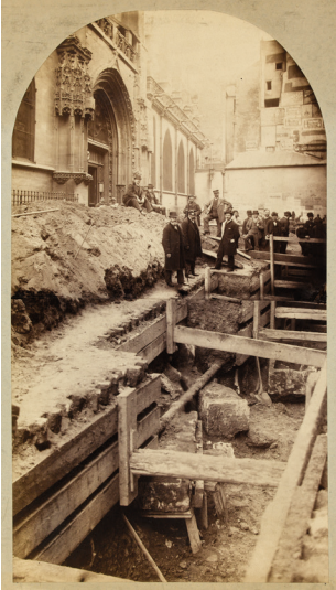
Groupes d'hommes sur le chantier de fouilles de l'église Saint-Germain-l'Auxerrois, place du Louvre, 1 er arrondissement, Paris.
