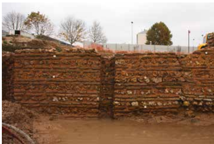
↑ Fig 4 : Mur de cave composé d'assises successives de silex et de terres cuites architecturales.
